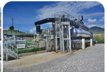
Bagnore余热发电站
