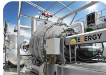
Arezzo余热发电站
